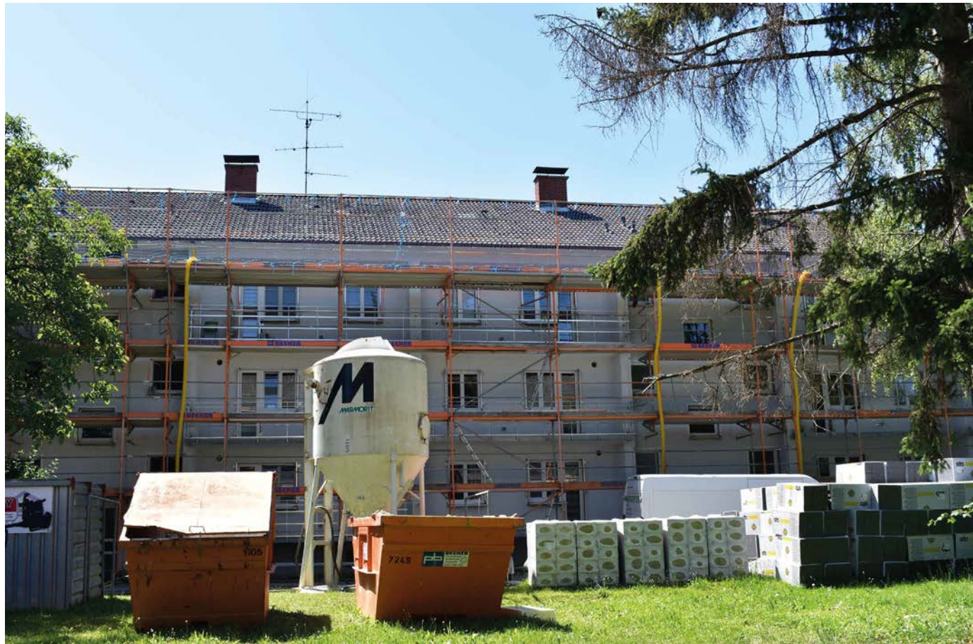
Grißheimer Weg 28, Heitersheim vor der Sanierung
