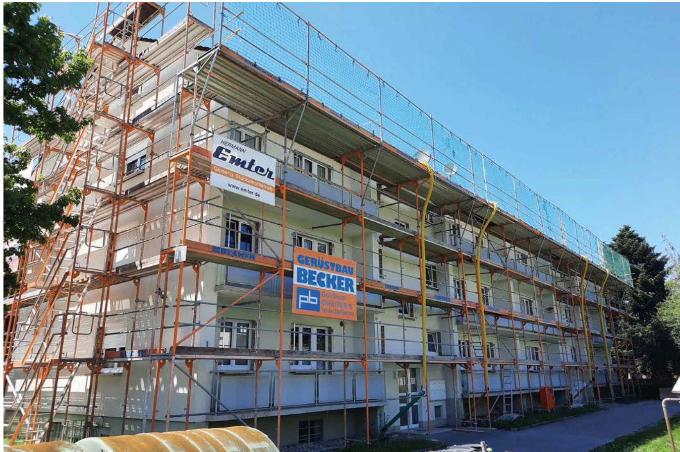
Grißheimer Weg 26, Heitersheim vor der Sanierung
